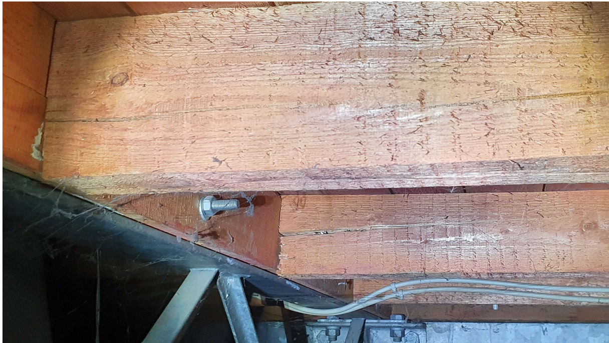
Längsrisse in den Tragbalken durch falsche Überblattung
